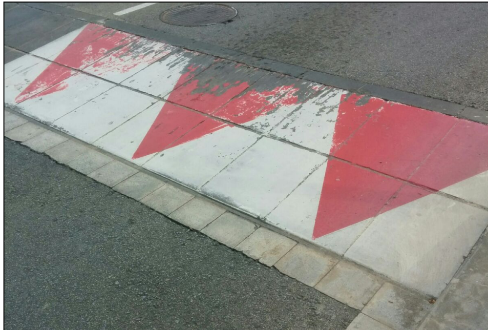
Fig. 7: Imagen de un paso de peatones con resalte con evidencias del contacto con los vehículos.
